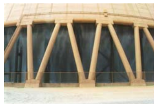
Obr. 5.35. Detail pilířů chladicí věže; za nimi voda stékající z výplně
